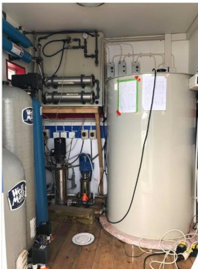
Figur 10 Avsaltningsanläggning i båthuset.
