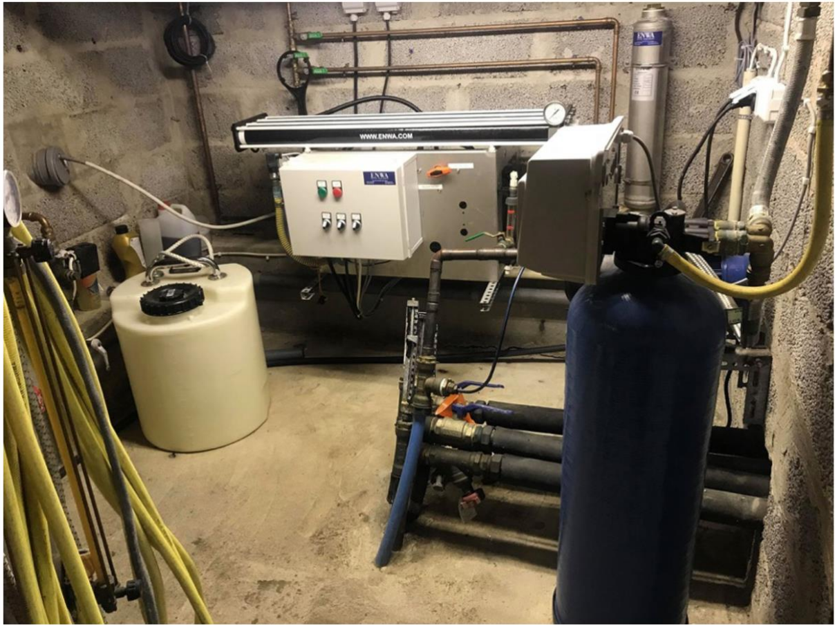
Figur 14 Avsaltningsanläggning i hushållet 2
