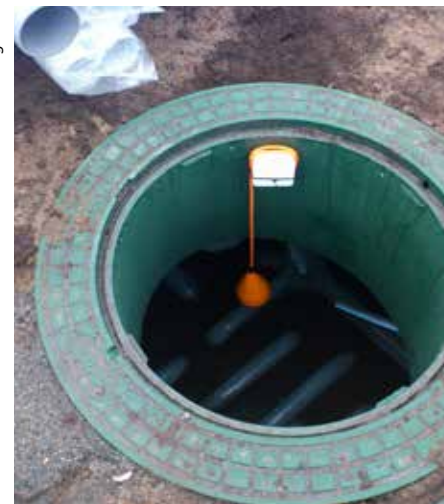
Tank med larmvipa och anslutna ledningar.
