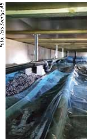
Ledning i kryppgrund.
