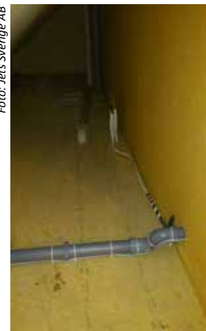
Ledning på vind.
