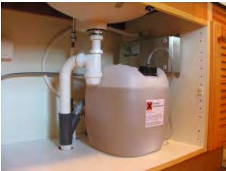
Figur 13. Installation i huset för kemiskfällning i slamavskiljare. På bilden ses kemikaliebehållare och styrenhet placerad under handfat i badrum.
