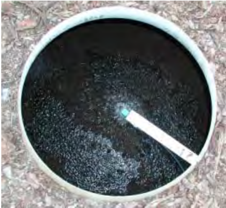
Figur 11. Dysa för spridning av avloppsvattnet över sprayfilter.
